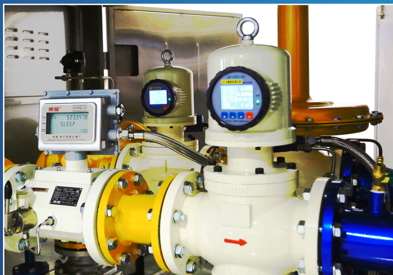
北京亦庄智能调压箱
